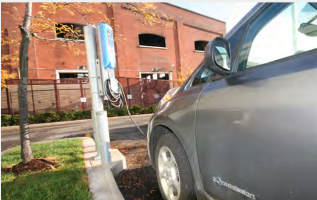
[Borne de recharge pour véhicule électrique dans le Technopôle Angus à Montréal, crédit : Société de développement Angus]
